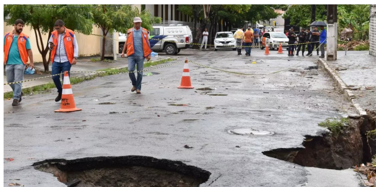
Atividade da Braskem causou afundamento de diversos bairros em Maceió
